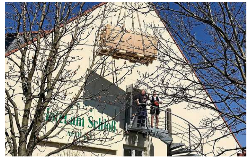
Mittels Kran von Jochen Kürbs wurden die neuen Warmwasserspeicher am Süd-Giebel ins Dachgeschoss des Hotels gehievt.
