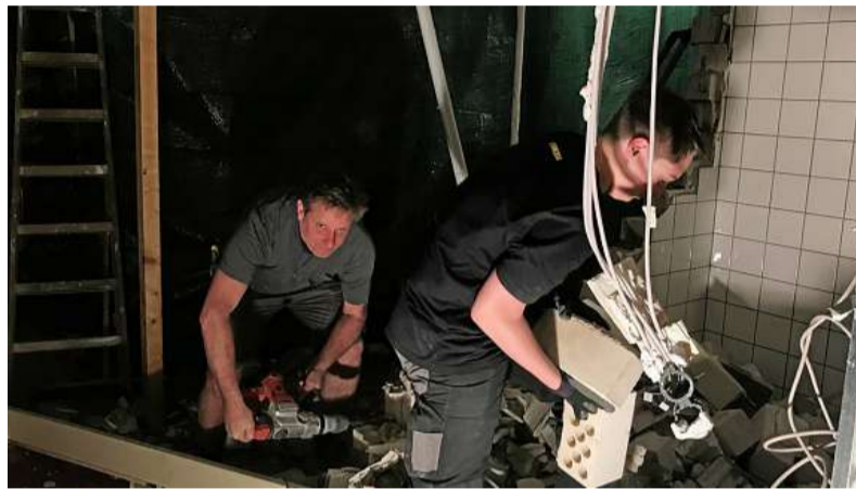
Sven Meyer (links) beim Abbruch des alten Sanitärbereichs im Keller des Hotels. Dort entsteht eine neue Behindertentoilette. FOTOS: DIRK LORENZ-BAUER
