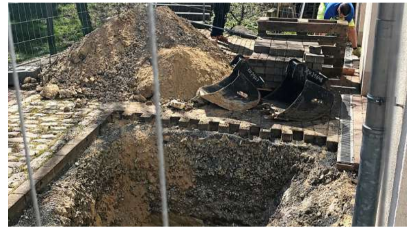
Im Innenhof des Hotel Schloß Apolda sind die Handwerker derzeit zudem dabei, eine undichte Stelle im Heizungssystem zu finden.
