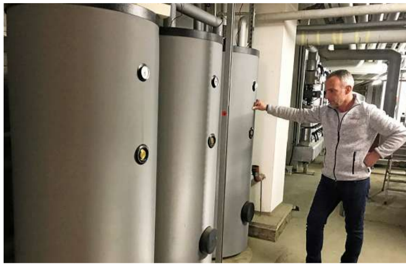
André Bartl von der Apoldaer Firma HKS Gebäudetechnik an einigen der Warmwasserspeicher im Dachgeschoss des Hotels am Schloß.
