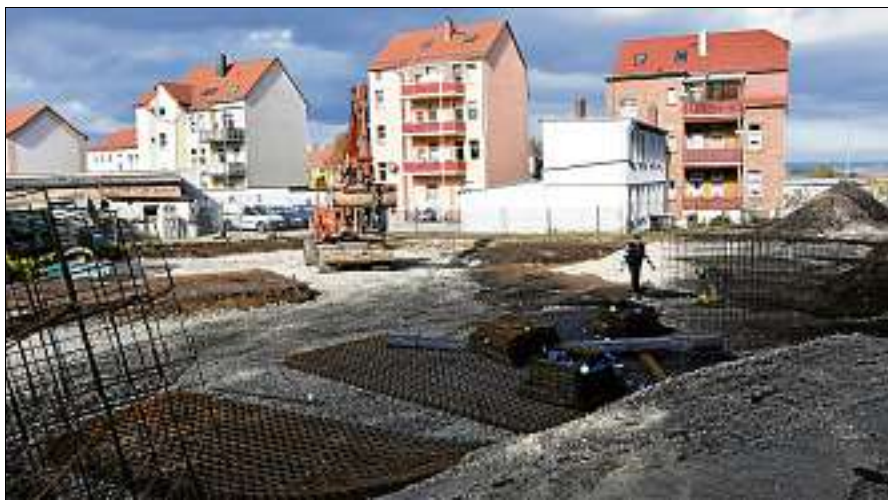
Vor rund einem Jahr hatte die Wohnungsgesellschaft Apolda dieses ans Bestattungsinstitut angrenzende Grundstück erworben. Dort laufen Vorbereitungen für den Bau eines Funktionsgebäudes. Das Bestattungsinstitut gehört zur WGA. Foto: Dirk Lorenz-Bauer
